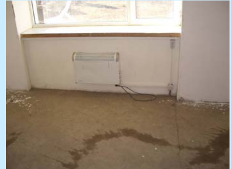
Schlecht isoliertes Haus mit Elektro-Ofen
